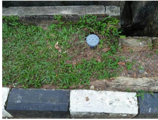
Gambar 4.4 Lubang Biopori Berada Ujung Belakang Bangunan Kantor Disperkim
